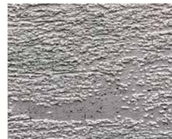
Degradace fasádní stěrky po 12 letech
