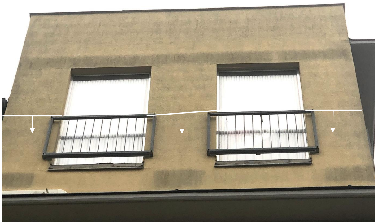
Praha, Zbraslav 10/2019 – těsně před aplikací FN NANO – ošetřeno bez mytí, od úrovně zábradlí dolů
